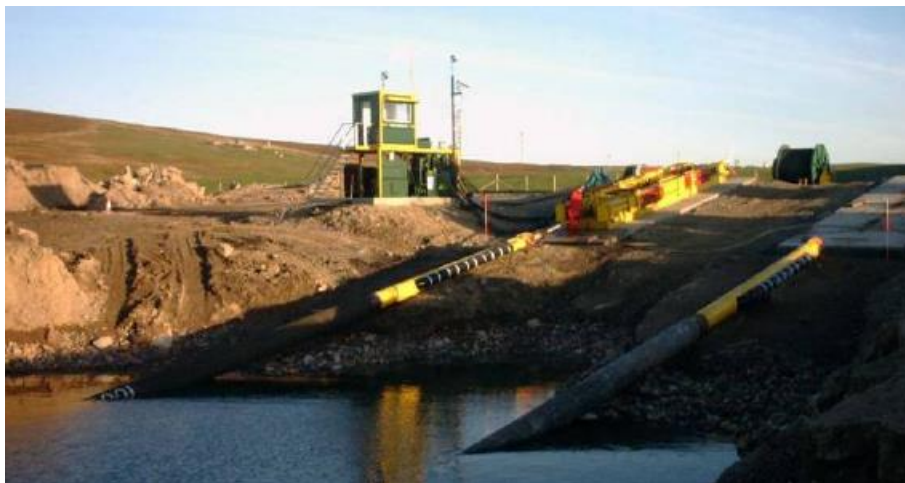
Figura 24: Foto di un esempio di collegamento all'argano su rampa inclinata.
